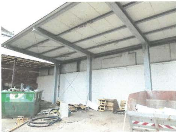
Abb.: offene Überdachung für Container
